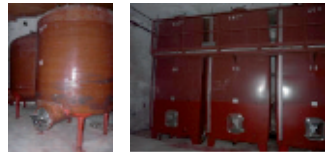
Nombreuses cuves résine et métal epoxy
