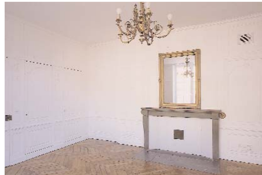
Un patient travail de repérage des lambris et des cheminées des vieux bureaux du Palais a été effectué avant les travaux.
