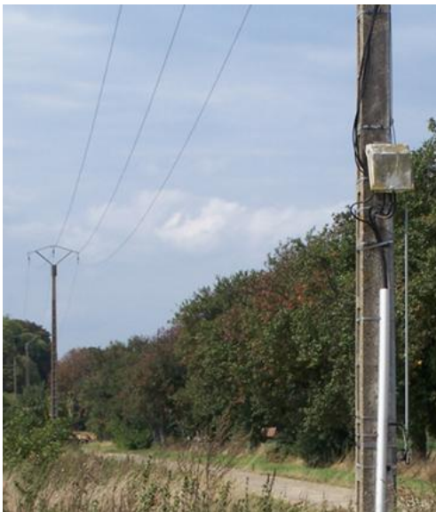
Réseau HTA (20 kV)
