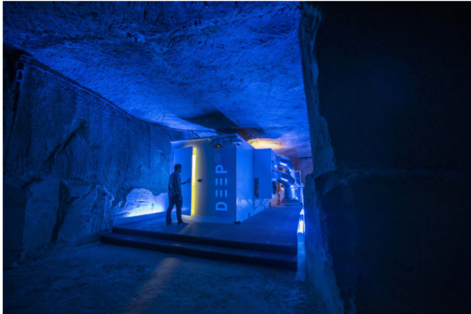
A Saumur, un data-center ultra performant installé au cœur des carrières souterraines
