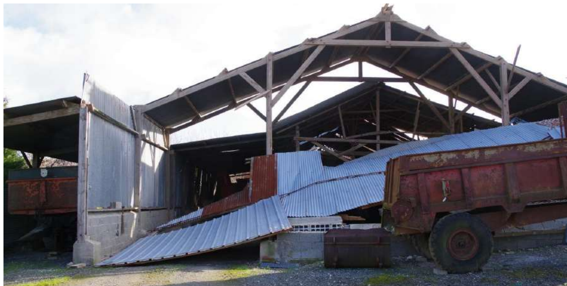
Le hangar n'a pas supporté les rafales de vent.
