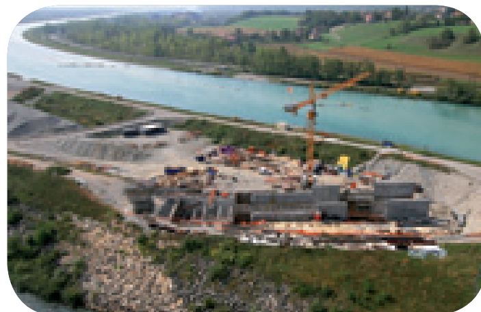
Centrales hydroélectriques de Chautagne et Belley, Barrages de Motz et Lavours (01) Hydroelectric power station
