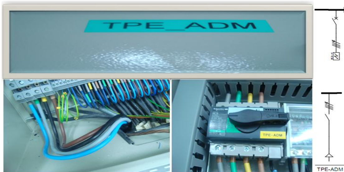
Figure 17: exemple d'un problème de câblage
