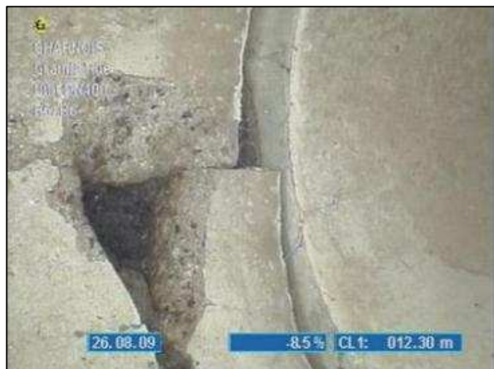
Photo n°3 : Eclatement : fissure biaise ouverte (casse).
