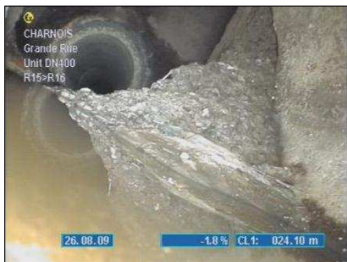
Photo n°8 : Dépôt de béton d'une épaisseur d'environ 25%.
