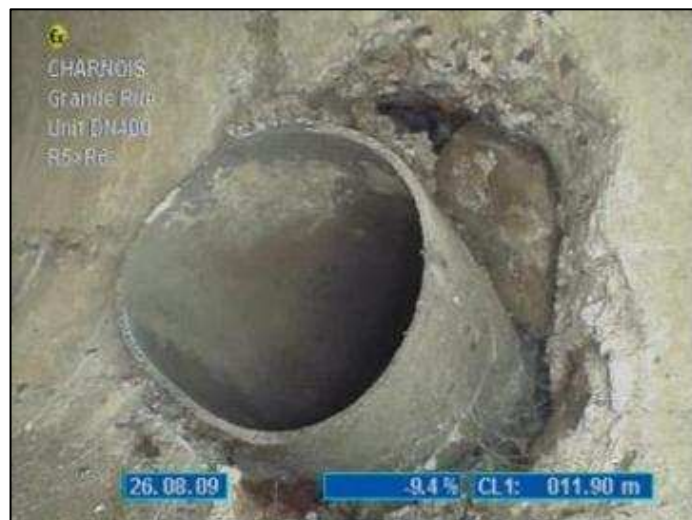
Photo n°4 : Branchement mal renformi avec percement mal découpé.
