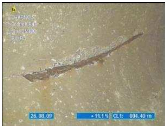
Photo n°1 : Dégradation du revêtement : fissure longitudinale.
