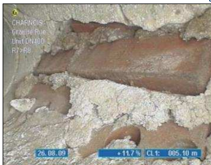
Photo n°5 : Effondrement partiel latéral et dégradation du revêtement.
