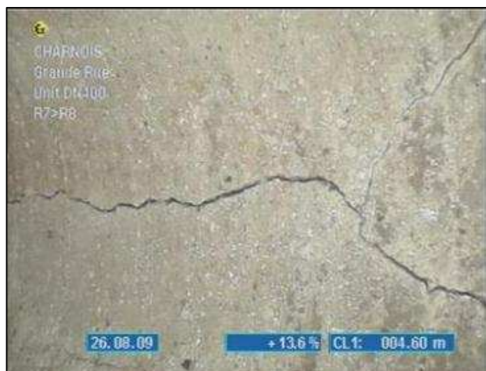
Photo n°6 : Fissure longitudinale ouverte (casse) de plusieurs ml.
