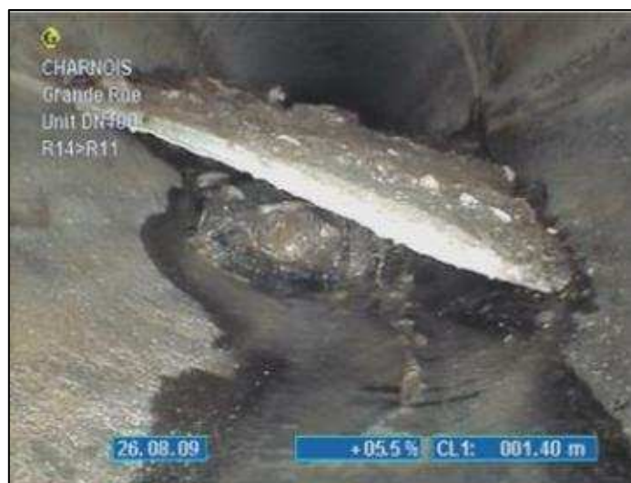
Photo n°7 : Dépôt de graviers et de ciment d'une épaisseur d'environ 50%.
