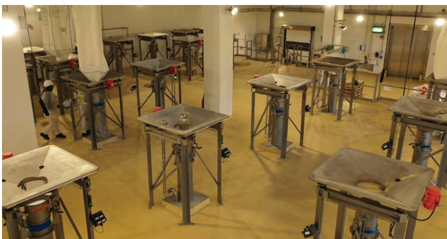
Au dernier étage se trouvent 25 postes de vidange pour les matières premières en big-bag.
