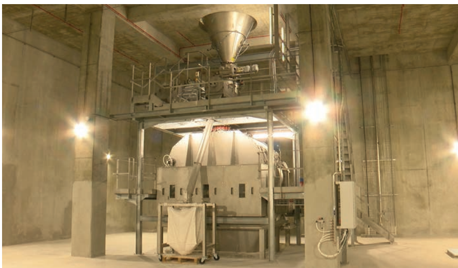
La mélangeuse est la pièce maîtresse de la nouvelle unité de production.
