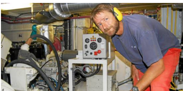
Philippe Jean, le chef mécanicien, dans la salle des machines, où vibre un moteur de 600 chevaux. Le bateau consomme environ 600 litres de gasoil aller-retour.
