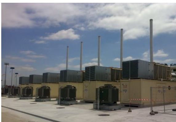
Unités de cogénération moteurs de l'installation Electr'Od
