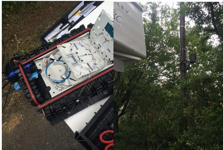
Figure 36 : Boitier d'épissure avec soudure entre abonné et réseau principal
