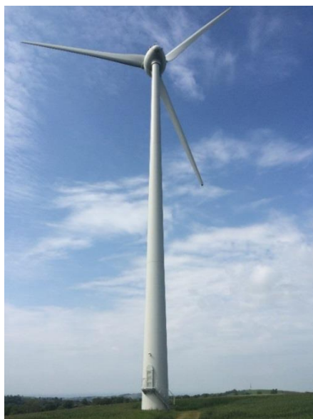
Figure 11 : Eolienne appartenant à la SERC, située à Montauriol
