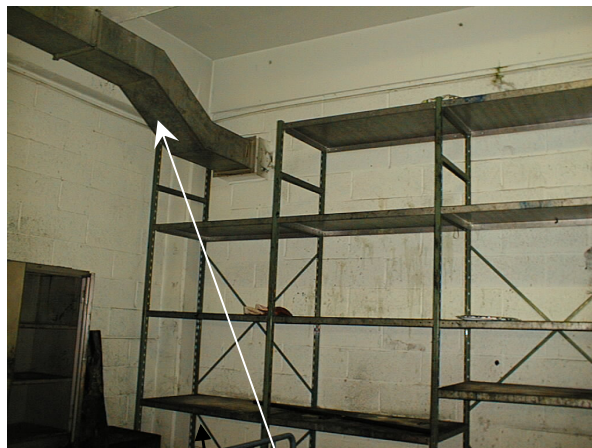
Gaine de ventilation conservée
