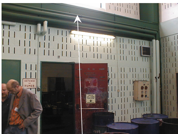
Réseau d'air comprimé
