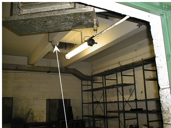
Tête de détection incendie conservée
