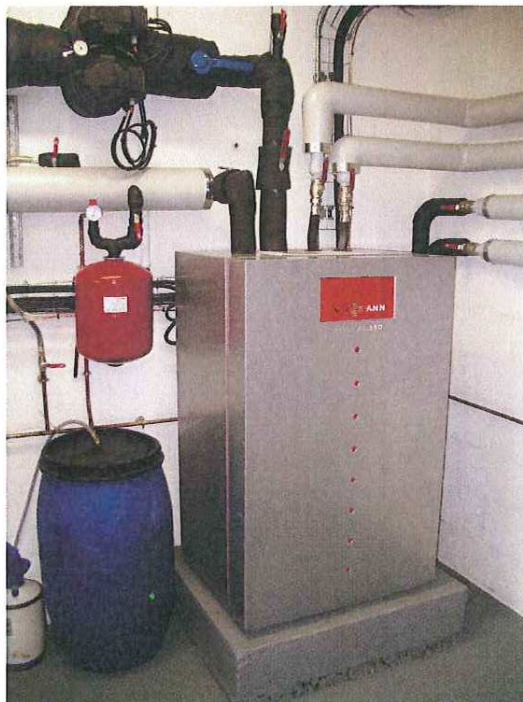
Pompe à chaleur
