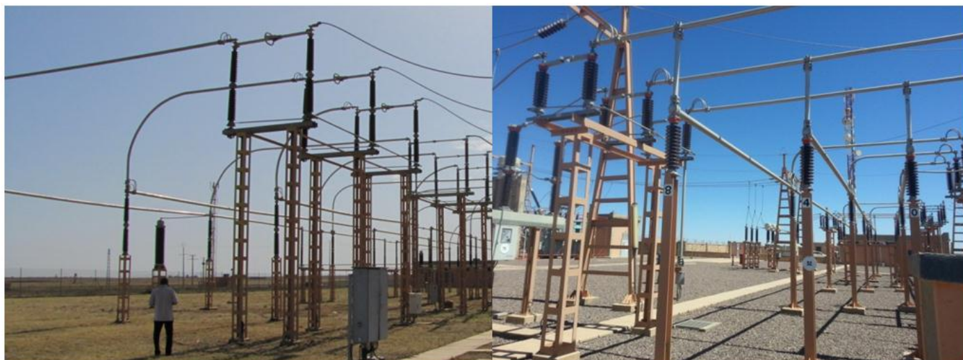
Figure 34: Jeu de barre 225 kV (à gauche) et 60 kV (à droite)
