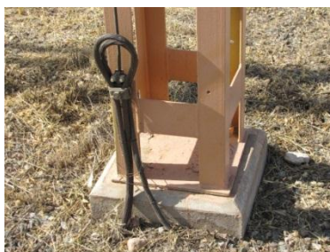
Figure 21: Mise à la terre des supports métalliques
