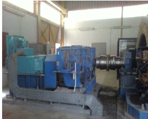
Figure 6 : machine à courant continue.
